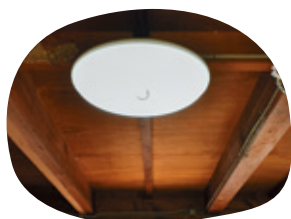
▲作業場にはむき出しの蛍光灯を設置していたが、飛散の危険があるため、カバー付きのLEDに変更
